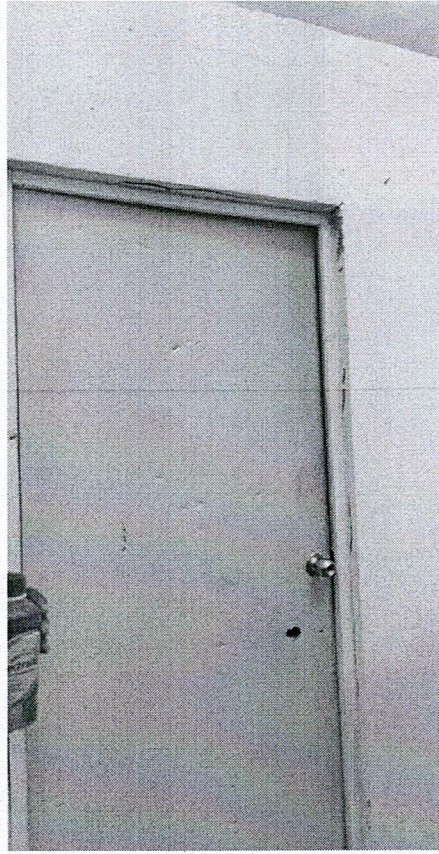
CHAPAS EN MAL ESTADO
