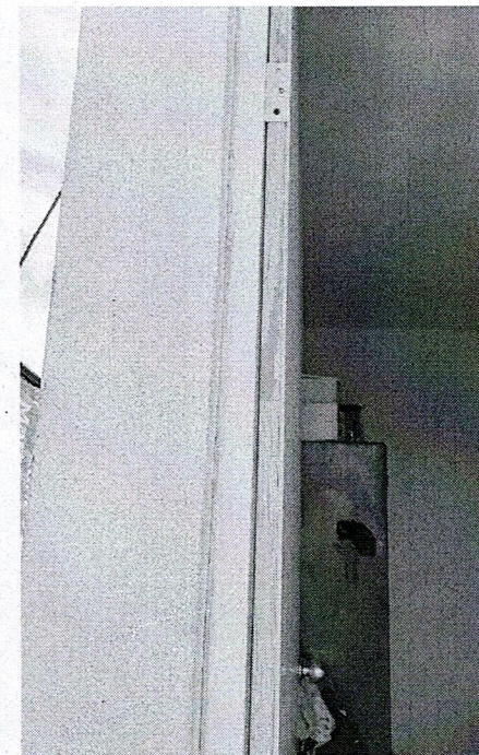
PINTURA EN MAL ESTADO
